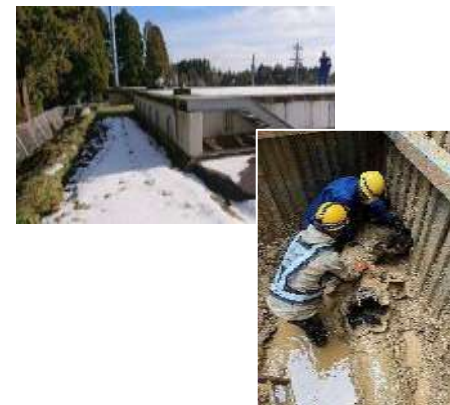
宝立配水池流入管の損傷
