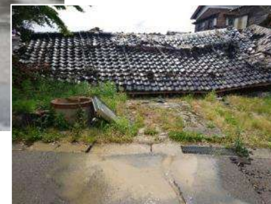
道路漏水（配水管の損傷）
