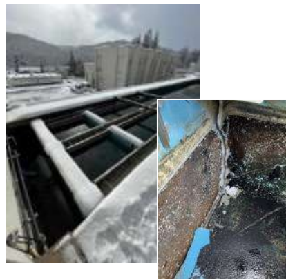
宝立浄水場浄水施設の損傷
