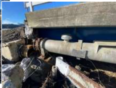
水管橋の損傷
