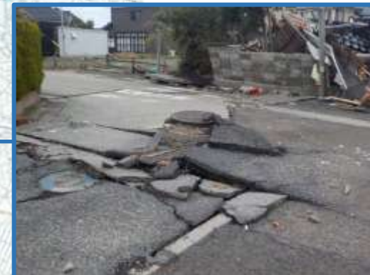
液状化・マンホール浮上
