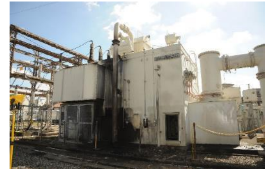
鉄道変電所火災 (令和3年10月)
