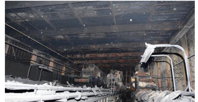
工場内部の焼損状況
