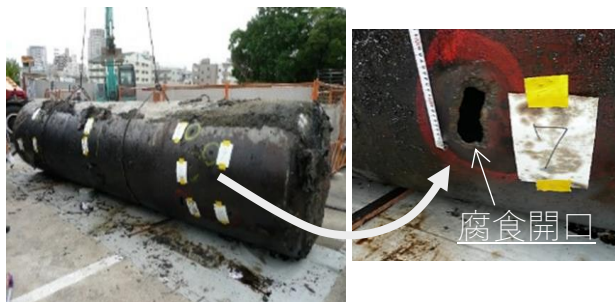
地下タンクの事故事例
