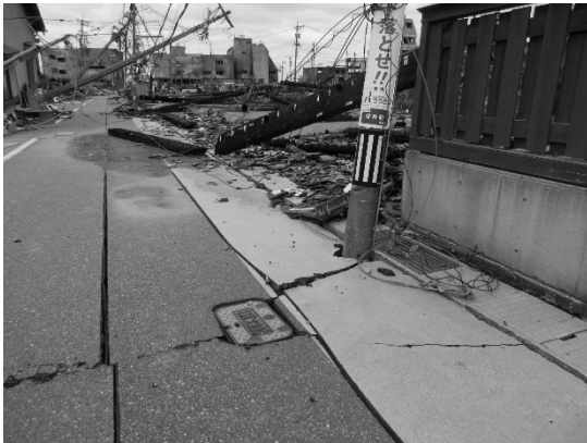
図2 河井町火災現場横の消火栓
